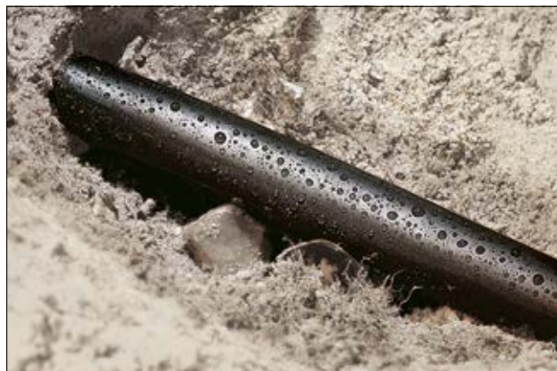
Tubagem de parede pesada.
